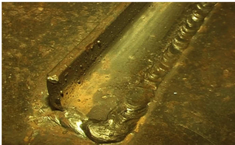
Рисунок 4 – Дефект зварного шва (наплив)
