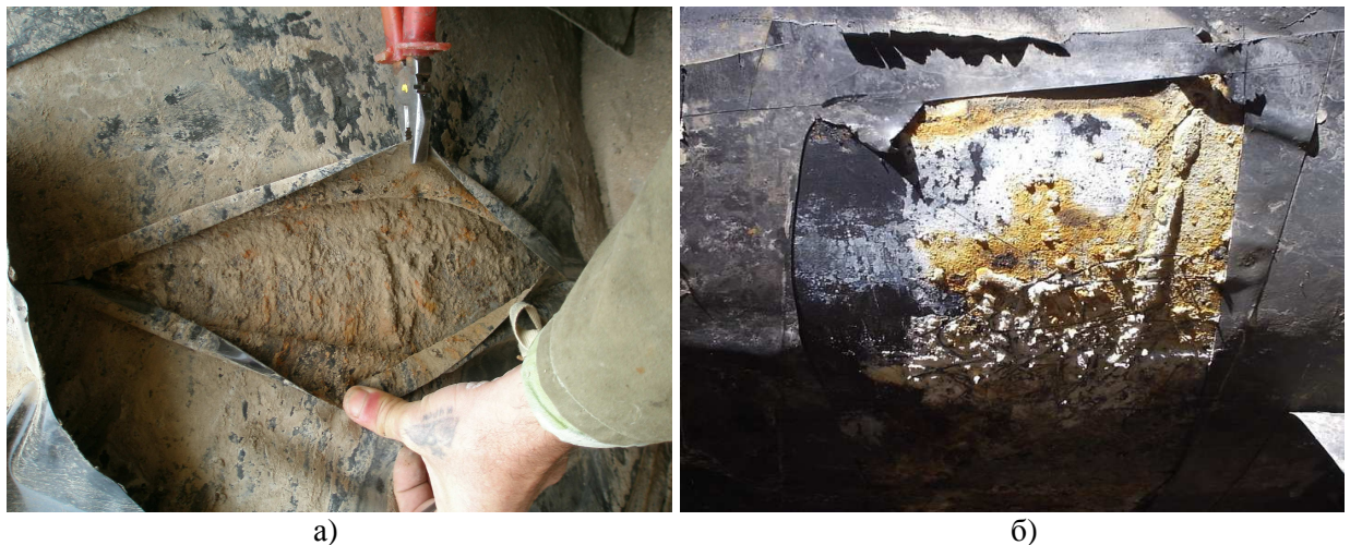
Рисунок 8 – Приклади відшарування ізоляційного покриття підземного нафтопроводу із корозійними пошкодженнями основного металу труби
