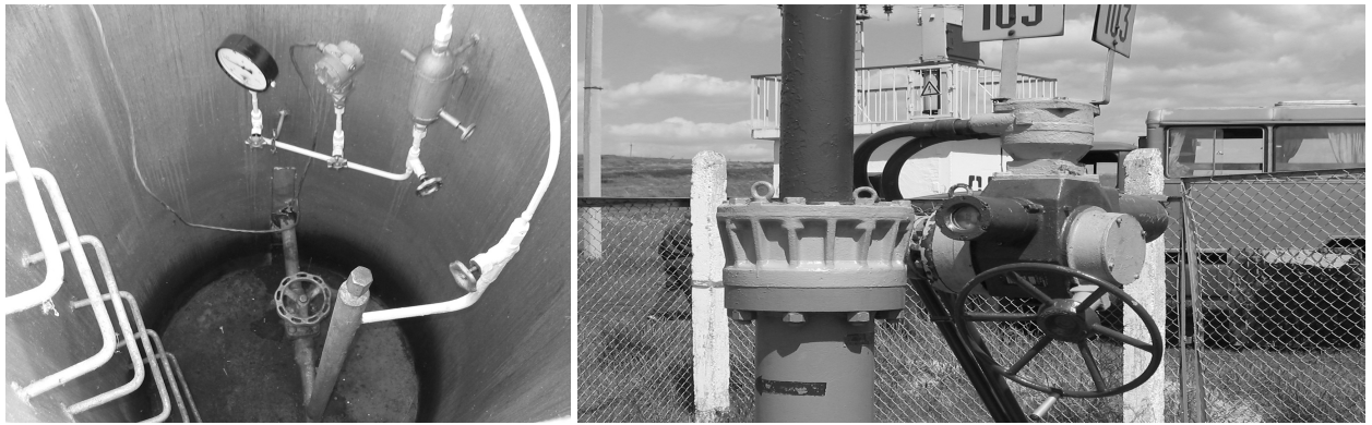
Рисунок 2 – Контрольний пункт системи телемеханіки на 986 км нафтопроводу
