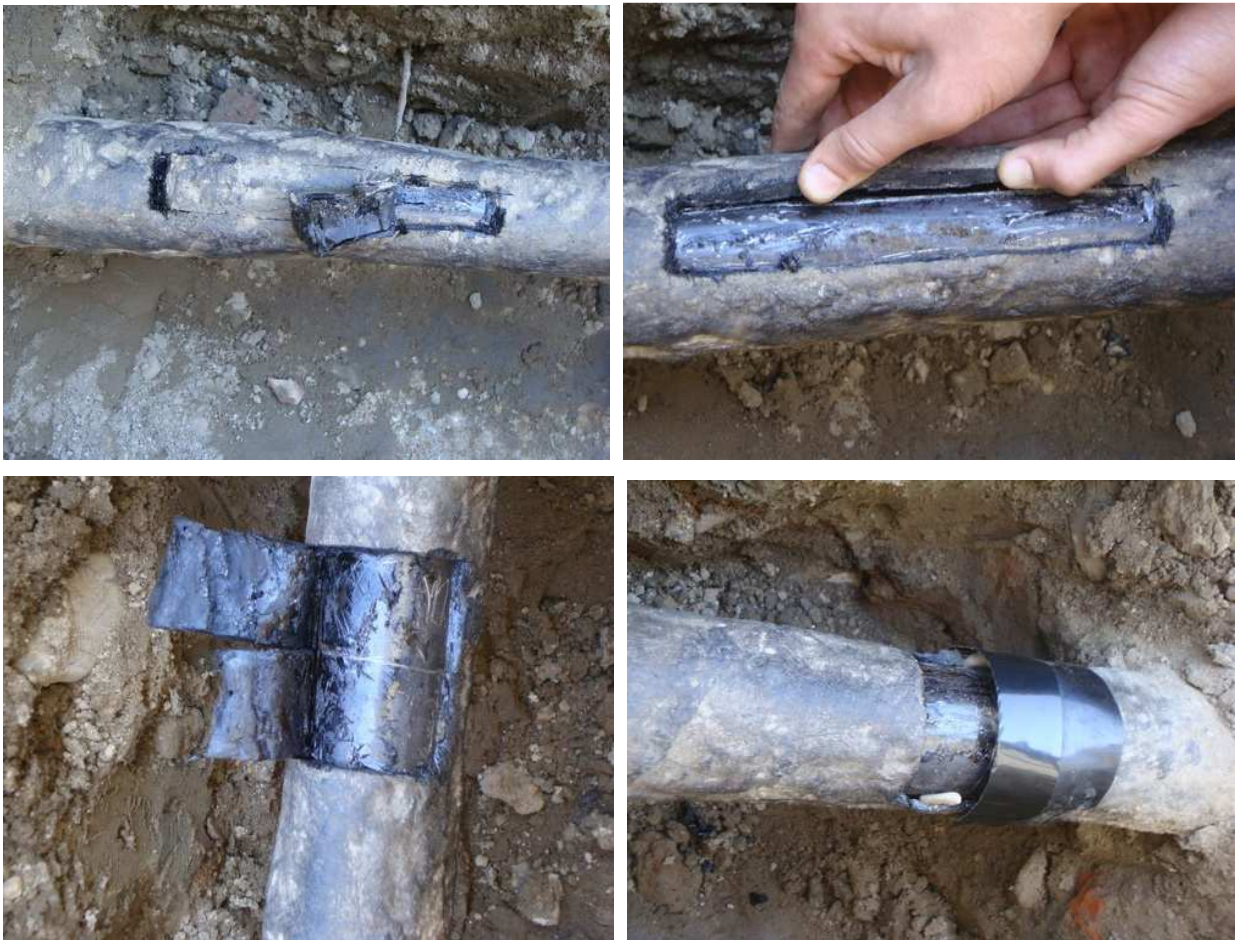
Рисунок 2 – Створені відшарування ізоляційного покриття
