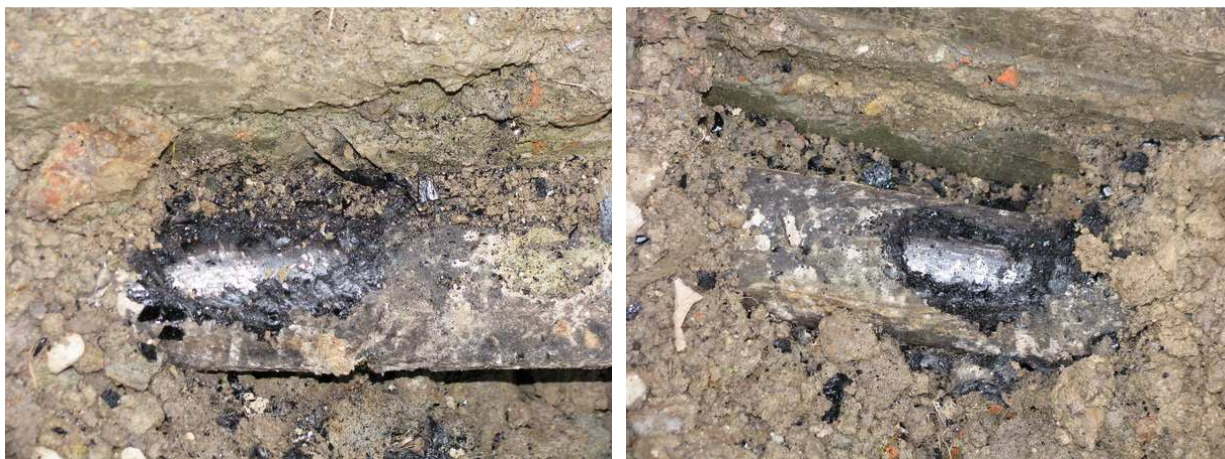
Рисунок 1 – Створені наскрізні дефекти ізоляційного покриття
