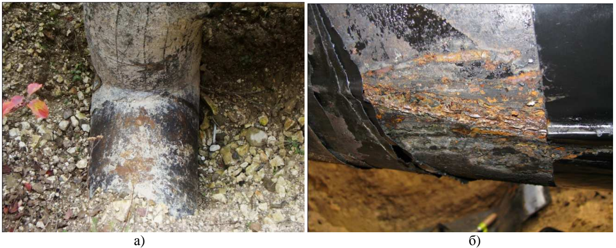
а) наскрізний дефект; б) відшарування ізоляції
